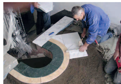
Verlegen der Platten auf den Podesten mit Granirapid als Sperre und Haftbrücke zum Mapecem-Mörtel
